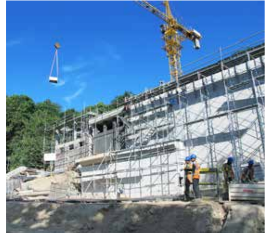
MONARAGALA-BUTTALA GEÏNTEGREERDE WATERZUIVERINGSINSTALLATIE Sri Lanka
